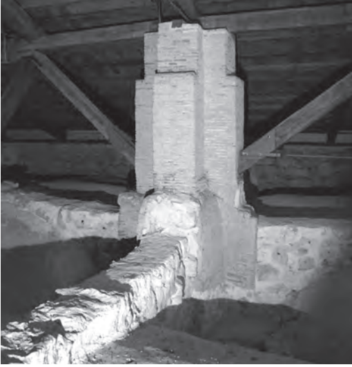
Figura 9 Pilares cruceta de fábrica de ladrillo, bajo cubierta Mota del Marqués (fotografía de R. Bellido)
