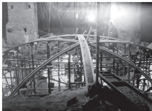
Figura 1 Reconstrucción de bóveda en Nava del Rey, Navarro 1995 (Archivo Central de la Consejería de Cultura, Junta de Castilla y León)
